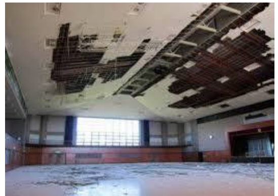
天井落下事故の事例写真
