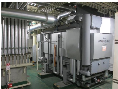
<写真②-1>機械室の空調設備
