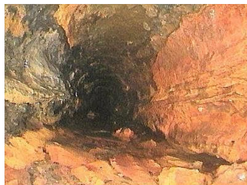
<写真②-2>雑排水管内部の状況
