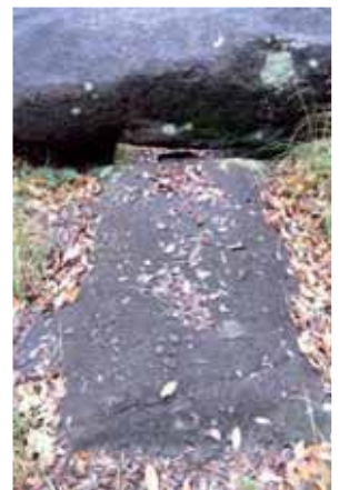
図 6-2 お亀石古墳 石槨部の劣化
