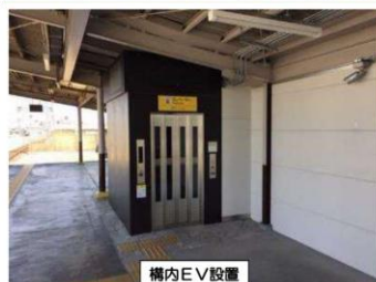
構内EV設置
