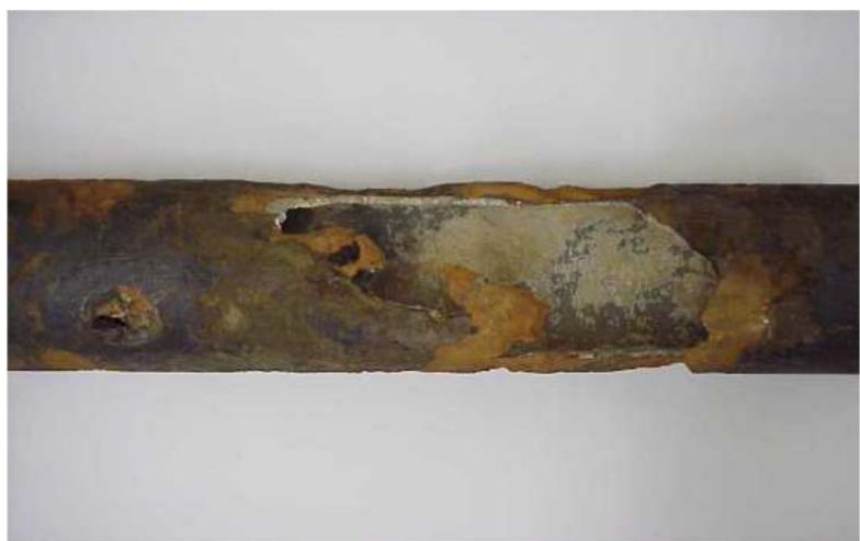
【老朽管】 出典：富田林市水道事業整備計画 H20.3
