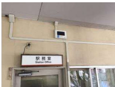
誘導チャイム設置
