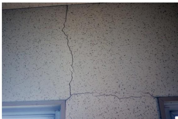
庁舎内のひび割れ(クラック)
