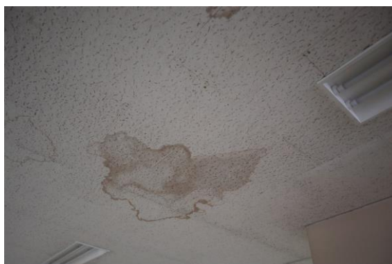
漏水による天井のシミ
