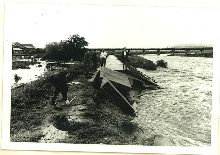
志石川堤防崩壊 42.7.9
