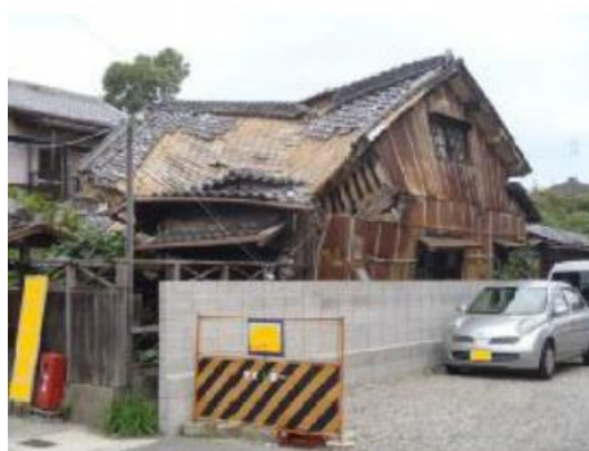
そのまま放置すれば倒壊等著しく保安上危険となるおそれのある状態の空き家
