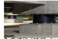
免震構造（積層ゴム）
