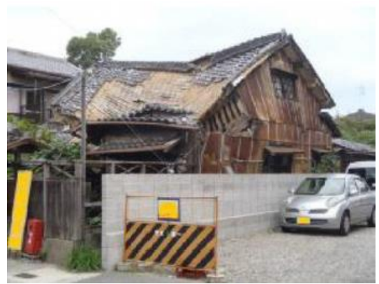
老朽化した危険な空き家 (老朽危険家屋に係るガイドラインの概要（大阪府）より)
